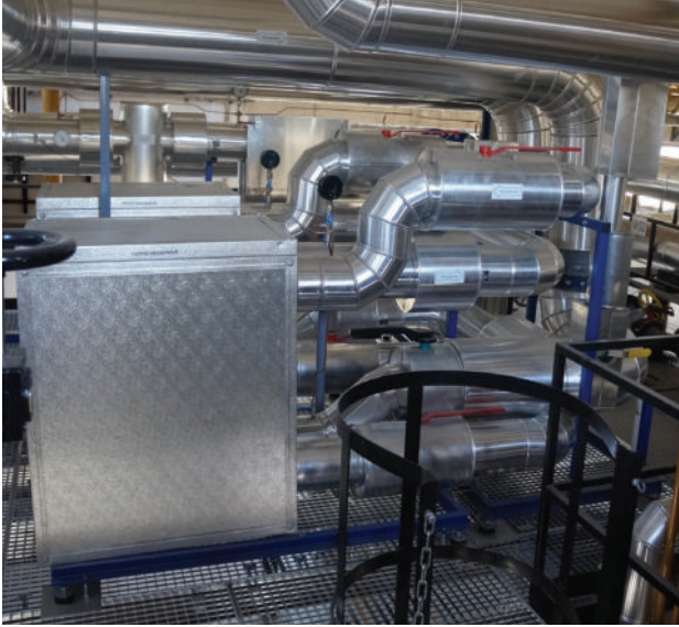
Modern és energiatakarékos hőközpont
