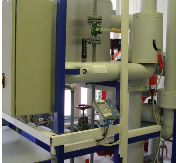
Korszerű hőközpont hőmennyiségmérő berendezéssel
